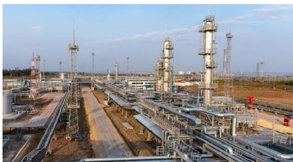
Компрессорные установки Ярактинское НГКМ
